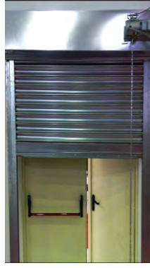
15 Sarmal Yangın Kapıları
