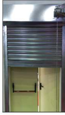
15 Sarmal Yangın Kapıları
